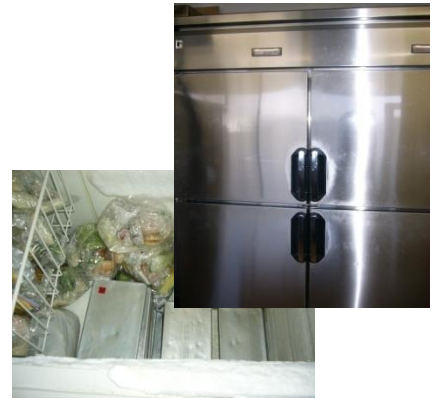
▲〈冷凍冷蔵庫と検食保管庫〉
